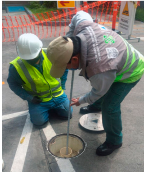
Atención a emergencia por presencia de hidrocarburos en la vía pública, SGIRPC.
